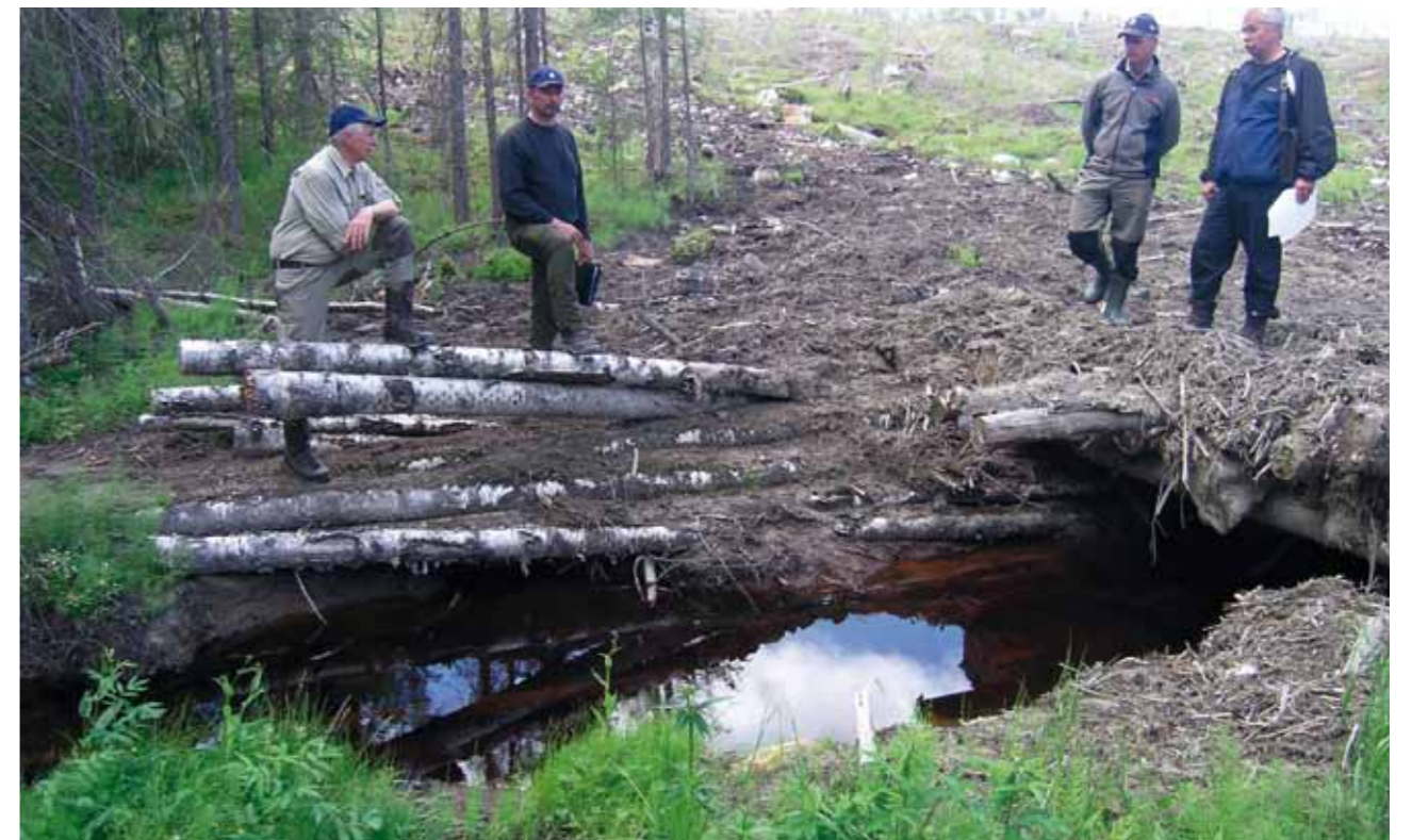
Trots att man byggt en bra bro har körskadorna medfört att slam transporterats ut i bäcken via körspåren. Det är viktigt att på- och avfarten till bron görs så att detta inte kan ske, till exempel genom risning eller kavling.
